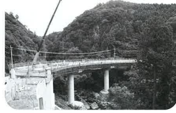
▲防衛施設周辺整備（平似田太ノ浦線道路改良工事） ～H24.2月末完成予定 ※写真は龍頭泉橋付近
